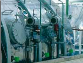
Sondes installées sur une cuite continue - FRANCE
